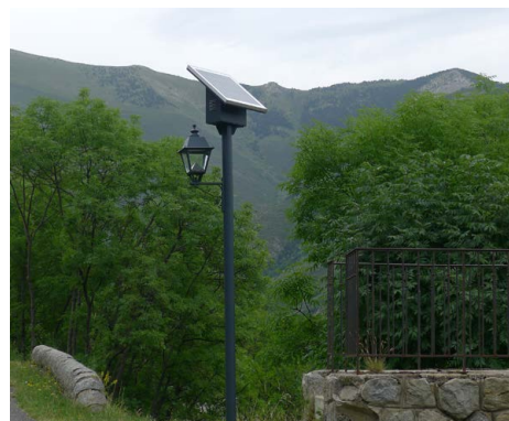
Lampadaires à énergie renouvelable dans les Garrotxes
